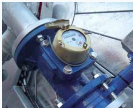
Compteur d'eau bridé sur entrée bobine.
