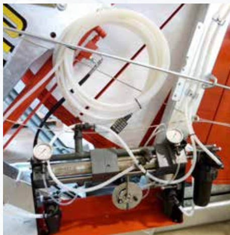
Pompe doseuse pour fertigation avec engrais liquide
